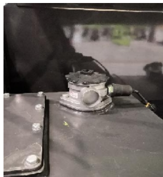
Рис. 5-4. Возвратный фильтр гидравлического масла
